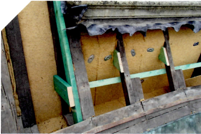
▲ Energetische Ertüchtigung: Die Gefache des alten Dachstuhls wurden mit flexiblen Dämmmatten aus Holzfasern gefüllt
