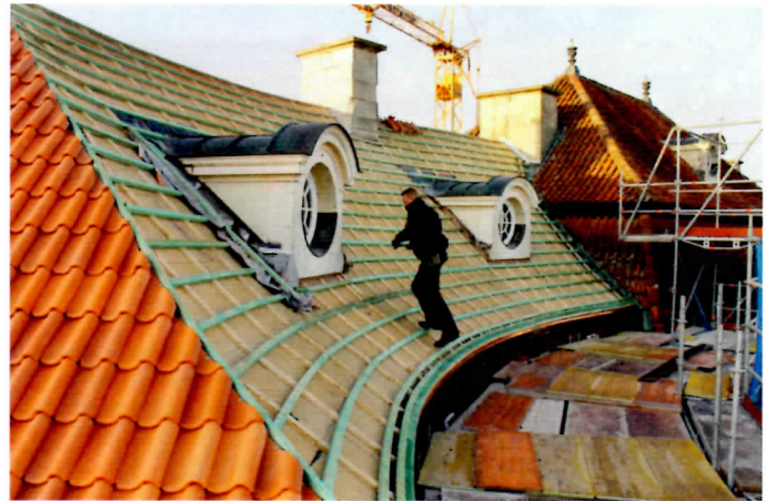
▲ Biegsame Platte: Die Unterdeckung besteht ebenfalls aus Holzfasern und ließ sich gut an die komplizierte Dachform anpassen
